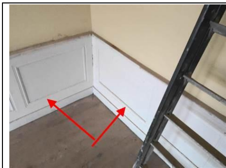
Photo n° PhPb001 Localisation : 1er étage - Chambre 4 UD : Mur (partie basse) Type de dégradation : Usure par friction Etat d'usage - Substrat : Plâtre - Revêtement : Peinture - Mesure : 7.5
