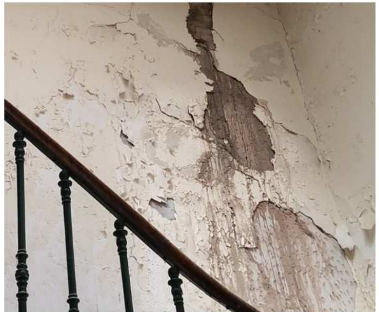
Traces d'infiltration derrière escalier Sud
