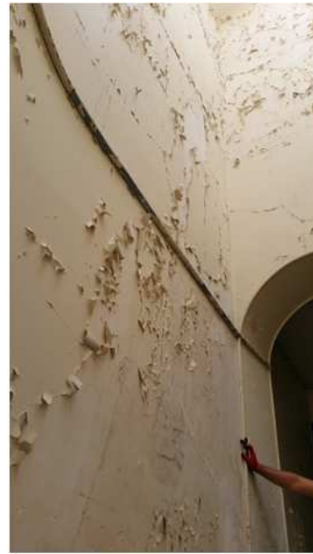
Traces d'infiltration derrière escalier Nord
