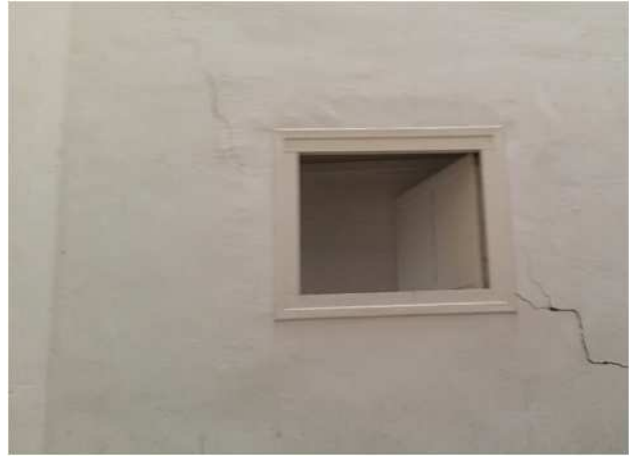
Fissures biaisées murs des courettes
